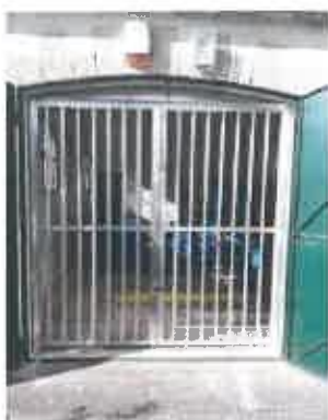
Grille cadenassée pour doubler la porte d'accès
